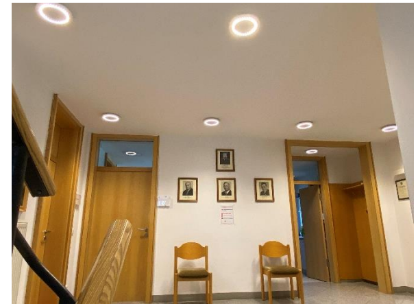
Neue Beleuchtung im Flur
